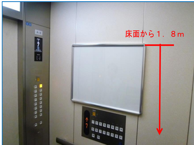
エレベーター内広告ポスター掲出枠①
