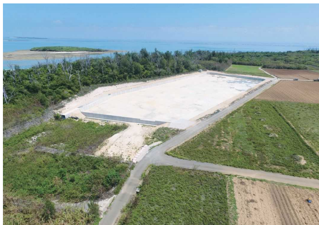
水利施設整備事業 津堅地区2号貯水池
