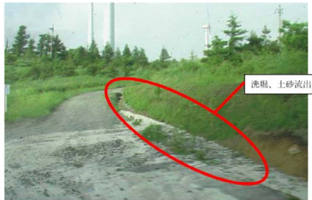
図2-6 道路脇が洗掘されて土砂が流出していた例
