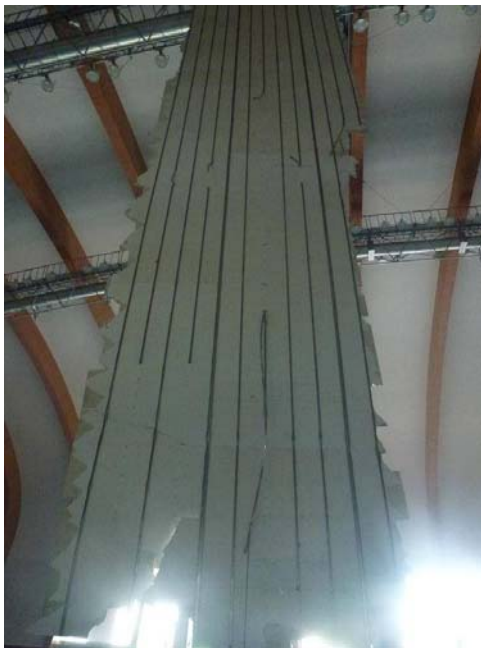
図 1 - 2 脱落した天井材
