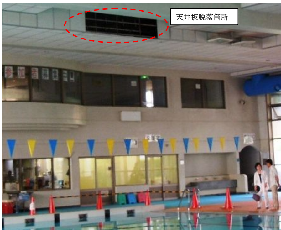
図 2-1 天井立ち上がり部脱落状況
