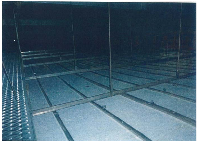
図 1 - 3 脱落部分以外の天井内クリップ外れ状況 1
