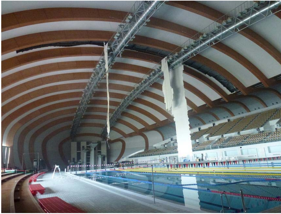
図 1 - 1 天井脱落状況
