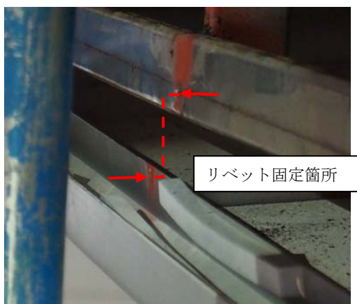
図 2-2 骨組み留め付けリベット抜け状況
