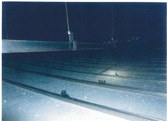
図 1 - 4 脱落部分以外の天井内クリップ外れ状況 2
