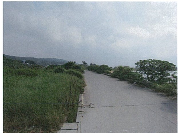
護岸防風林や排水溝も草木が繁茂しています。 （南西側から撮影）
