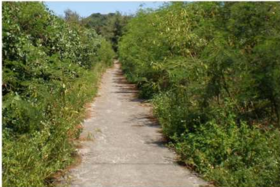
護岸天端のコンクリートが草木で覆われている状況
