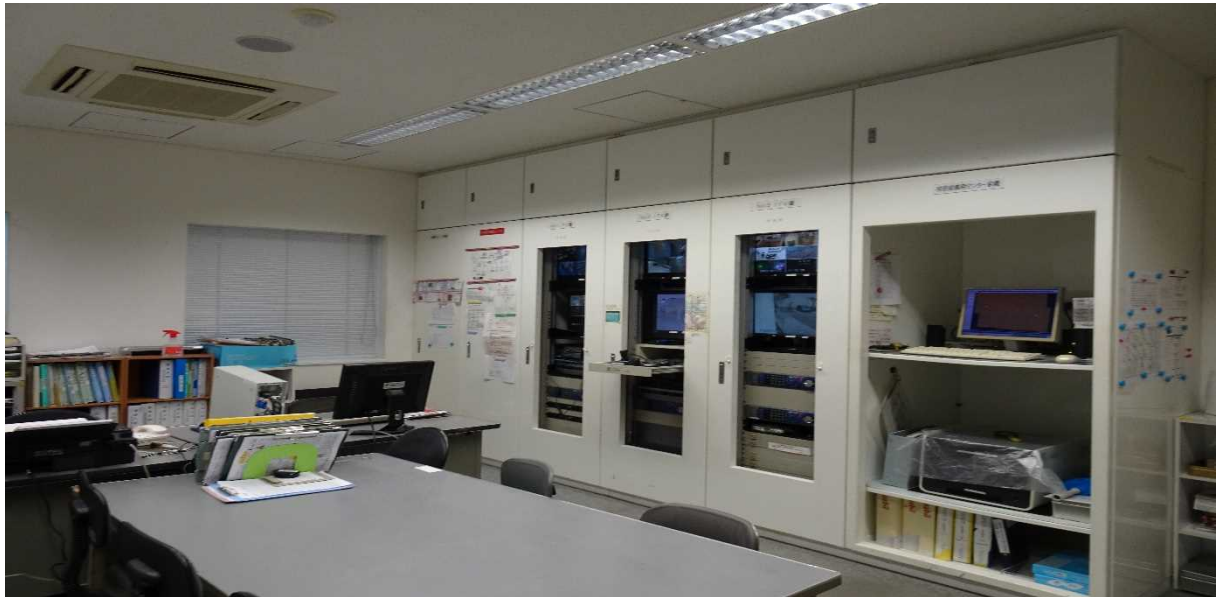
【防災センター】
