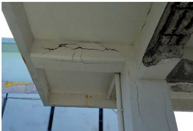
コンクリート劣化状況 剥離・剥落、鉄筋の断面欠損の状況
