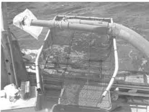
異物除去器の先端に異物を収集するネットの設置状況
