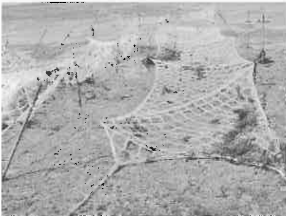
⑥ 10月29日真栄里網及び鉄筋の破損
