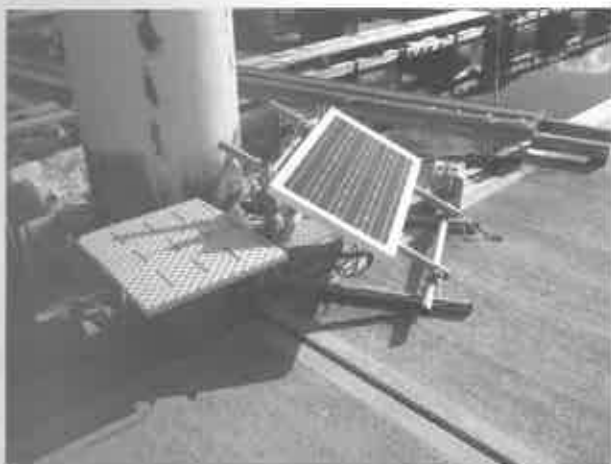
ソーラーでの銅イオン発生装置の設置
