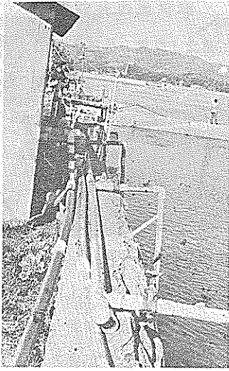
池底のパイプ配管
