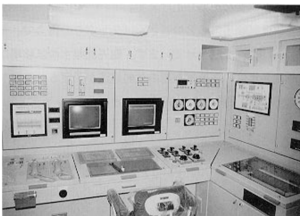
監視室監視盤
