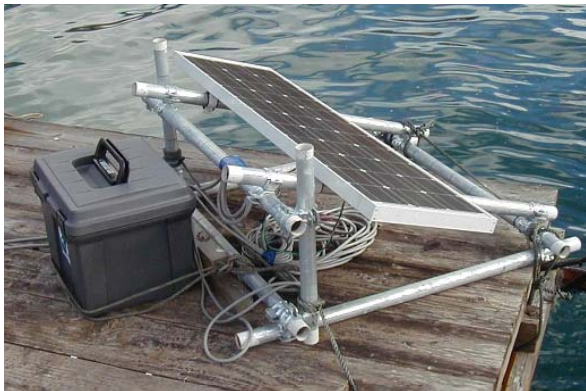
写真－２ 銅イオン発生装置の全景。 左のボックスがコントローラー，右が電源供給用の太陽電池パネル。
