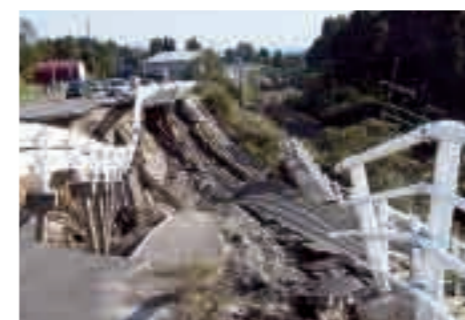
新潟中越地震による道路の決壊
