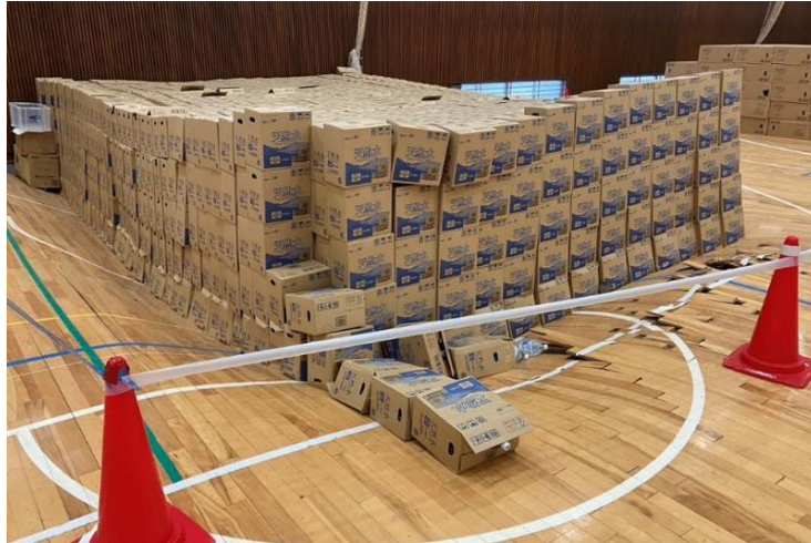
図表 1－2－2 物資拠点となった体育館で床が抜けたケース
