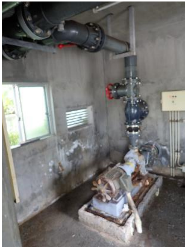
第2ポンプ室No.3ポンプ
