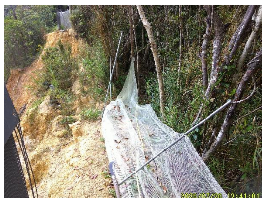
●第二柵の破損地点 2-19 (R6) ①
