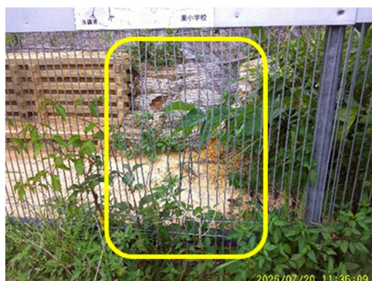
●第一柵の破損地点 1-6 (R6) 修繕スパン数：1枚
