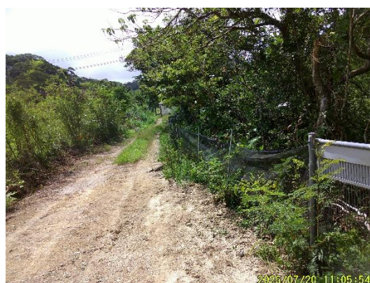
●第一柵の破損地点 1-4 (R6) 修繕を要する簡易柵の長さ：約18.5m
