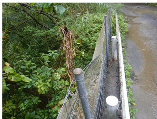
●第三柵の破損地点 3-3 (R8) 修繕スパン数：1枚
