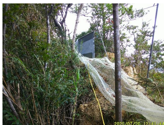
●第二柵の破損地点 2-19 (R6) ②
