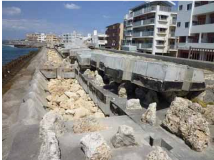
嘉手納町水釜地区 高波により損壊した堤防
