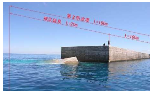
第2沖防波堤は、台風被災を数回受けており、波浪条件の見直しを行って改良を行う。
