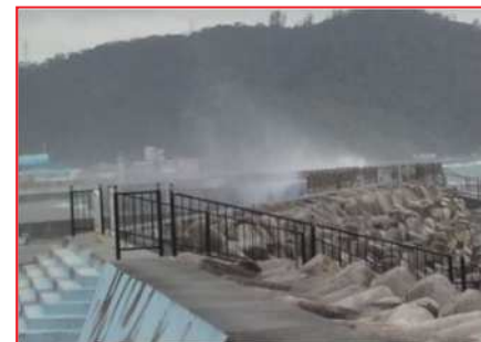
強風時の防波堤越波状況
