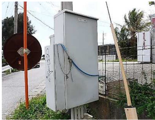
1号マンホールポンプ施設
