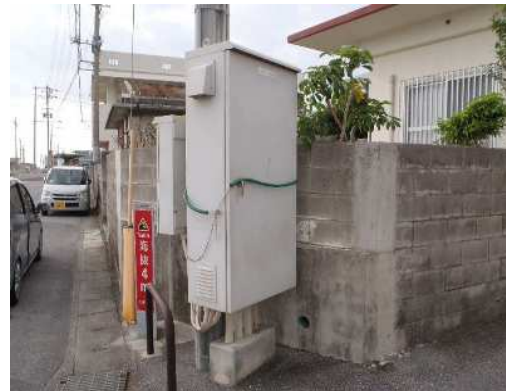
2号マンホールポンプ施設
