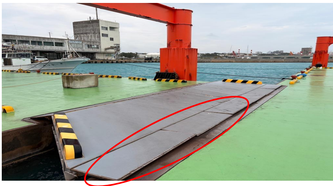
架台欠損に伴う変状
