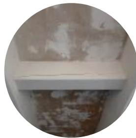
梁の横方向のひび割れ
