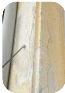
柱の縦方向のひび割れ
