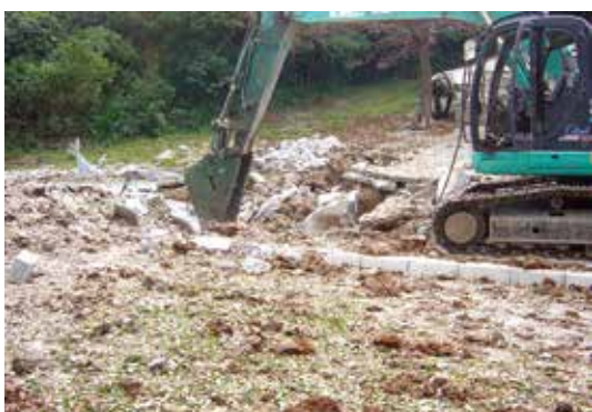
糸満市内の水道工事中に不発弾が爆発した後の様子 (平成21年1月)
