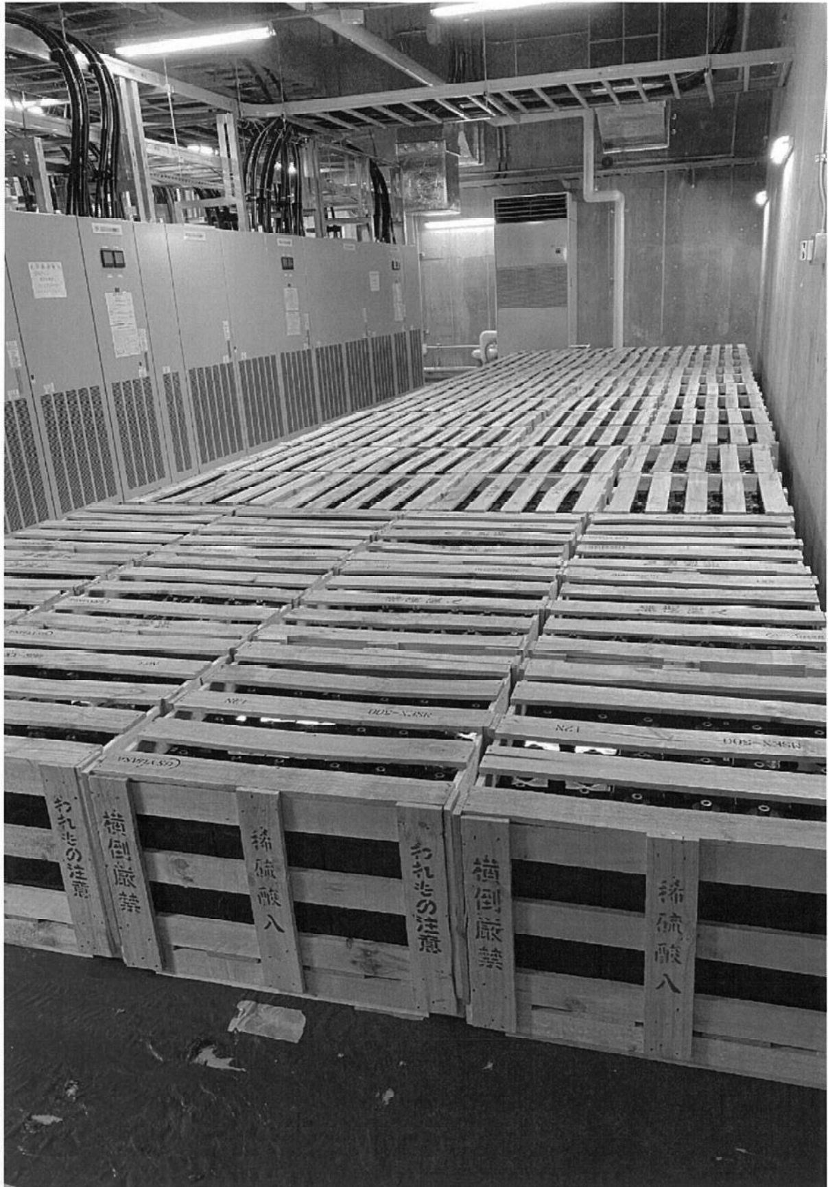
処分対象UPS蓄電池の保管写真
