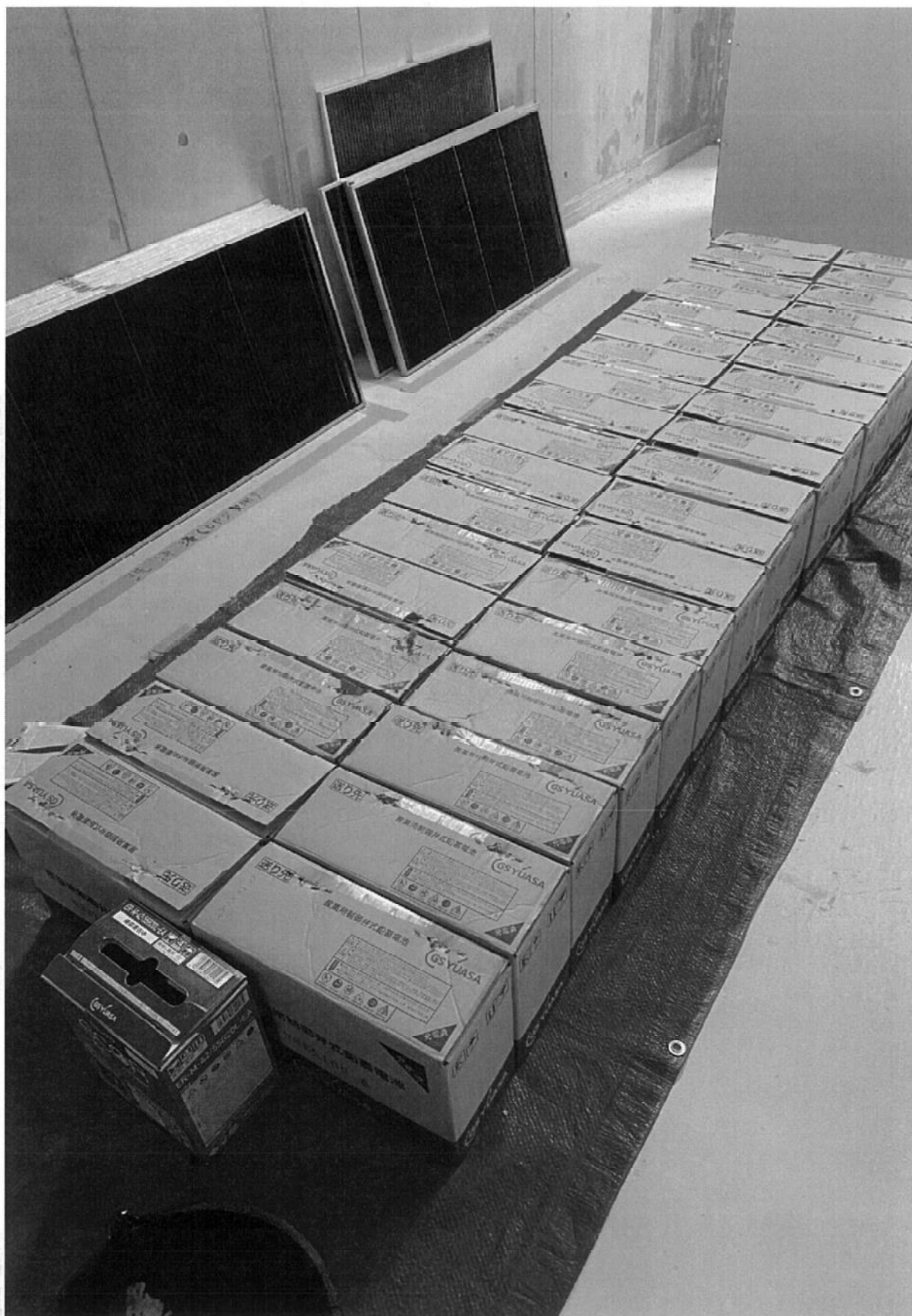
処分対象UPS蓄電池の保管写真
