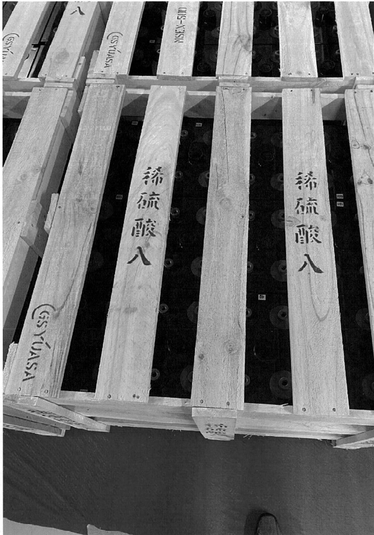
処分対象UPS蓄電池の保管写真
