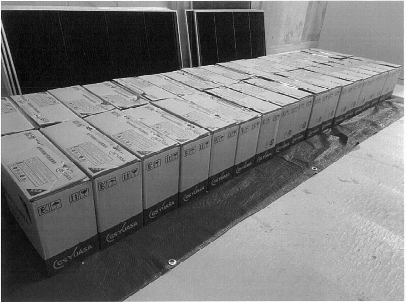
処分対象UPS蓄電池の保管写真
