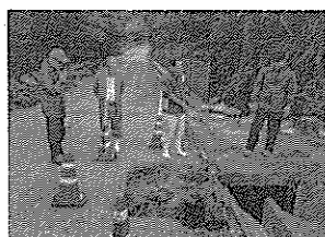
県道14号 大雨で陥没した道路
