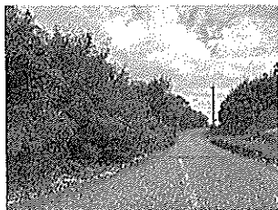
車道に雑草が繁茂
