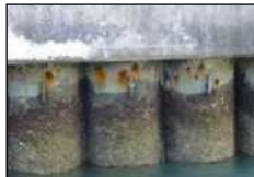
腐食が進行した 鋼管式防波堤
