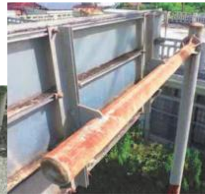
【事例：県道14号線（横梁）】
