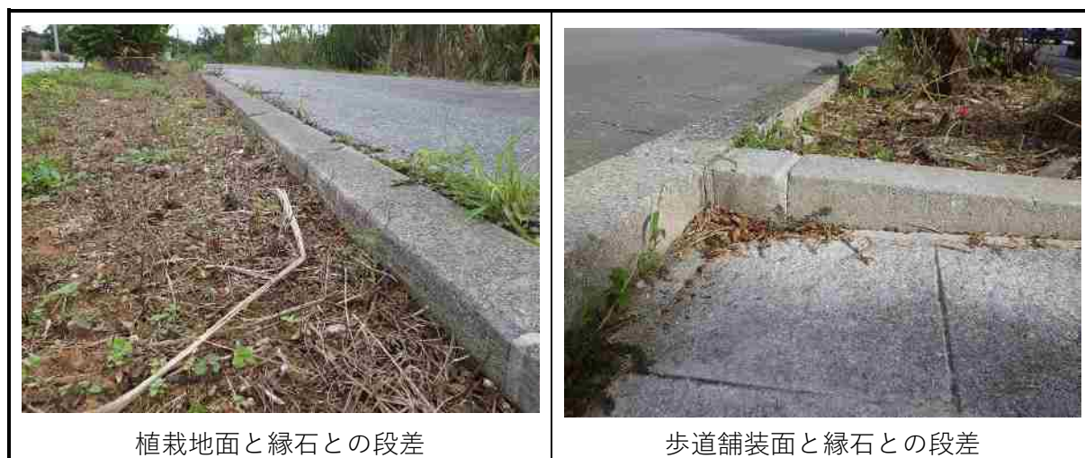
写真 2.4.1 縁石と植樹帯や歩道舗装面との間に生じる段差
