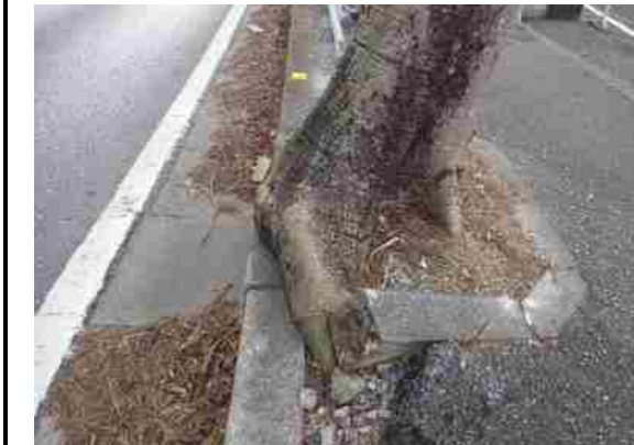
根上がりによる縁石・歩道の破損
