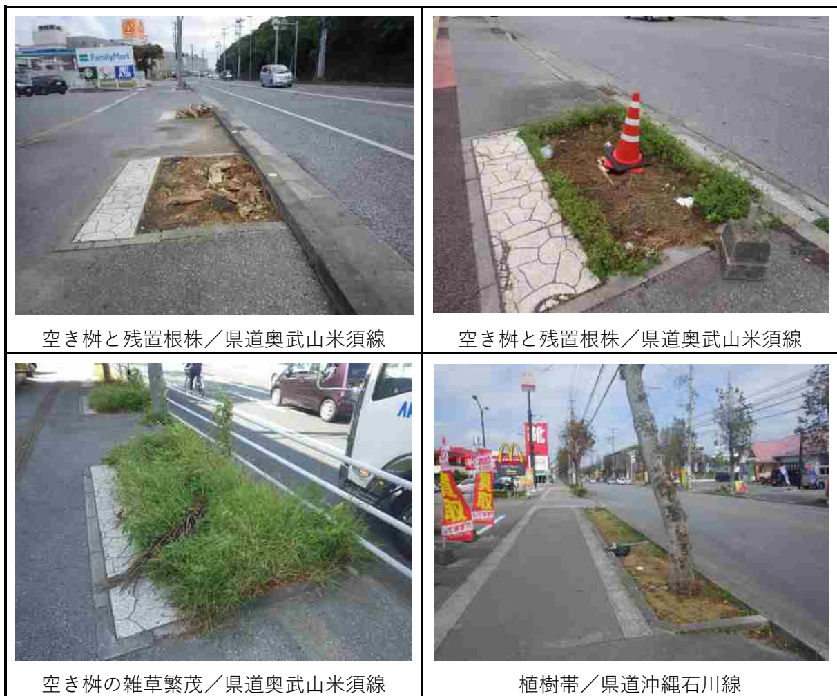
写真 2.5.5 沿道にみられる空き桧
