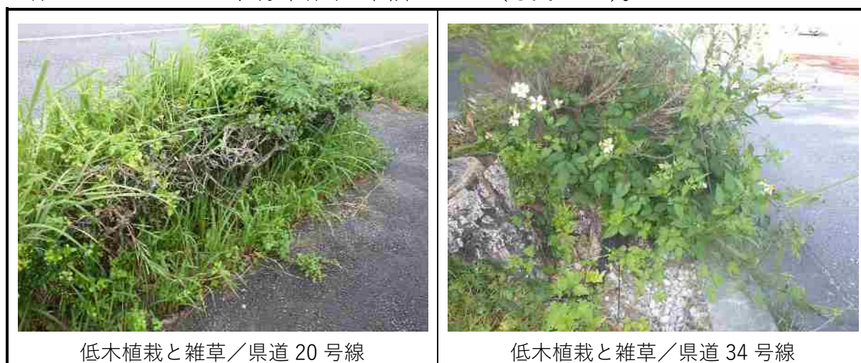
写真 2.4.2 低木植栽の植栽基盤から発生した雑草の伸長
