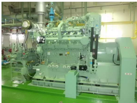
消化ガス発電機
