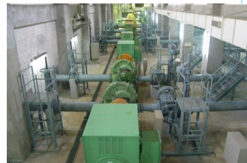
増圧 ポンプ場
