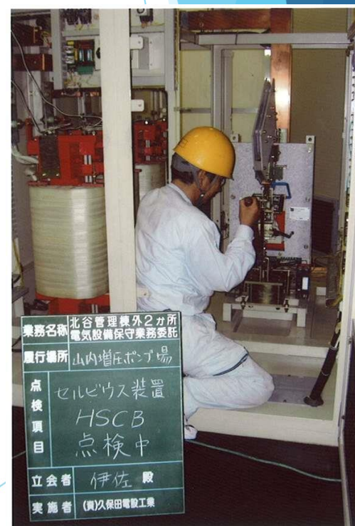
電気・計装設備保守点検 (電気)
