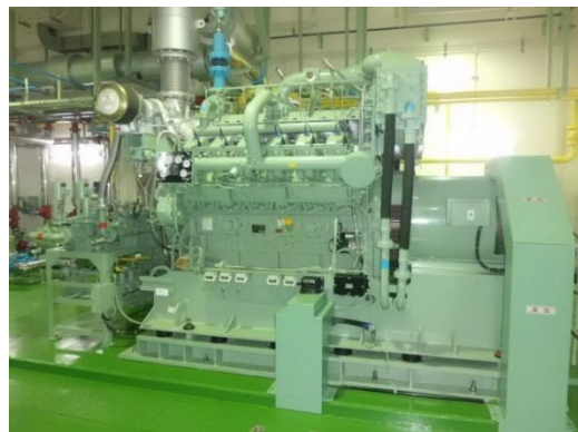
消化ガス発電機
