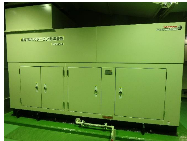
自家発電設備
