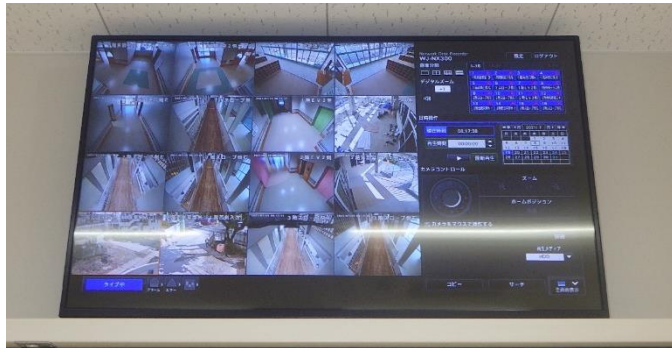
防犯カメラ設備
