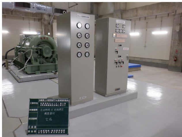
運転操作設備（現場操作盤）
