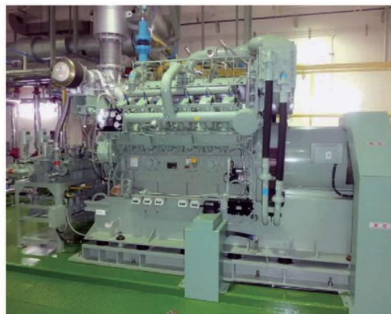
消化ガス発電機
