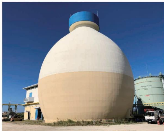
汚泥消化タンク
