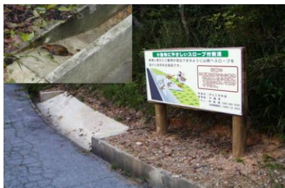
スロープ型側溝（伊江Ⅱ号林道）
