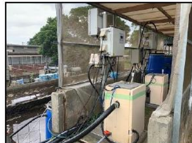
■ BOD監視システム (酸化溝法)
