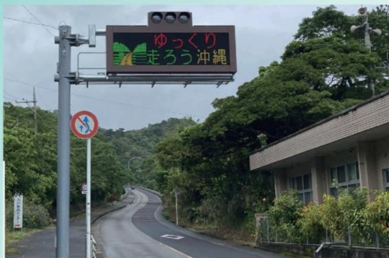
◀道路情報板の設置 (名護市大川)
