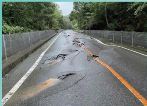
●2021.11豪雨により発生(名護市源河)
