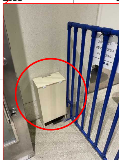
保安検査場：B側 * 収納BOX内へ設置
