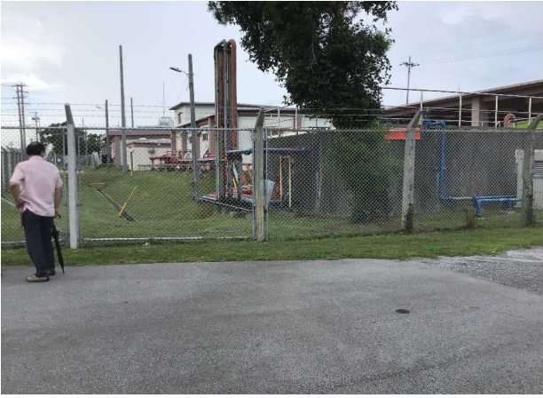
米軍基地関係特別委員会 令和3年6月15日 うるま市昆布 米軍貯油施設 汚水漏出現場視察
