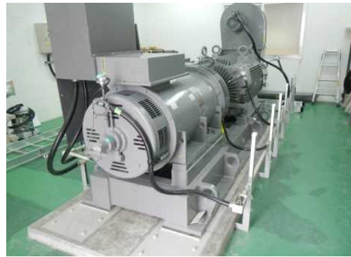
図表ウー3 小規模離島における再生可能エネルギー最大導入事業実証機器
