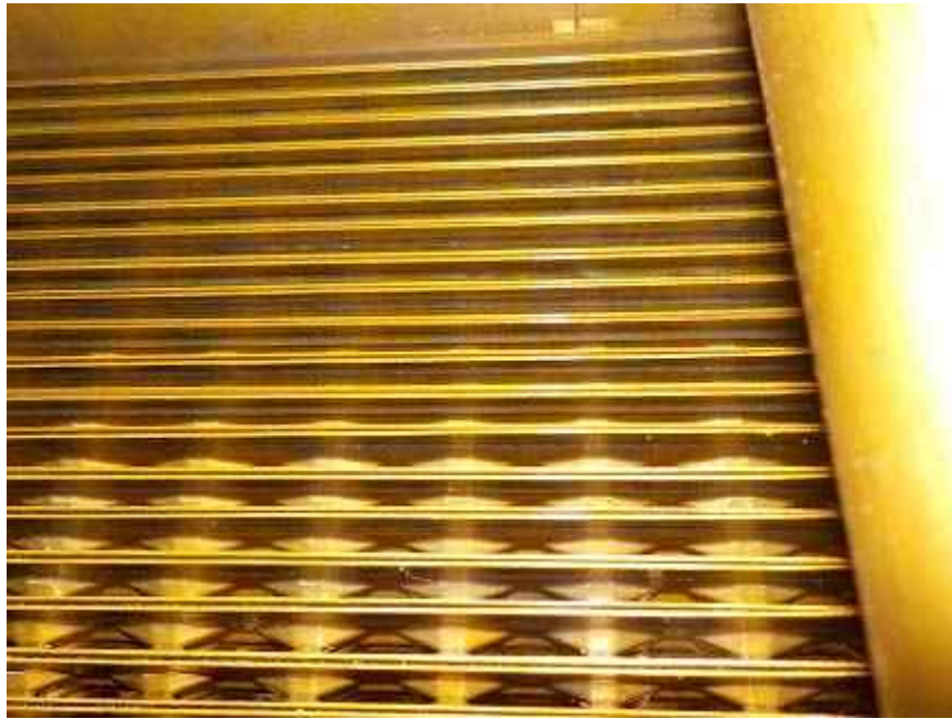
図 3-16 ユニット B 蒸発器 プレートバンドル部入口
