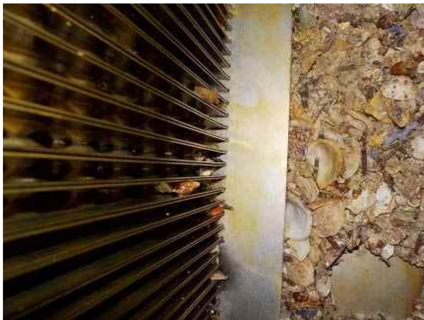
図 3-17 ユニット B 蒸発器 プレートバンドル部入口下部の貝類滞留
