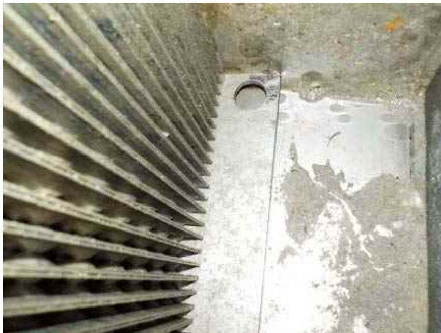
図 3-21 ユニット B 凝縮器 プレートバンドル入口下部
