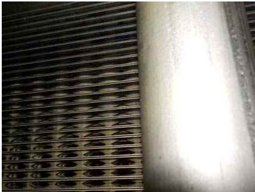
図 3-19 ユニット B 凝縮器 プレートバンドル入口
