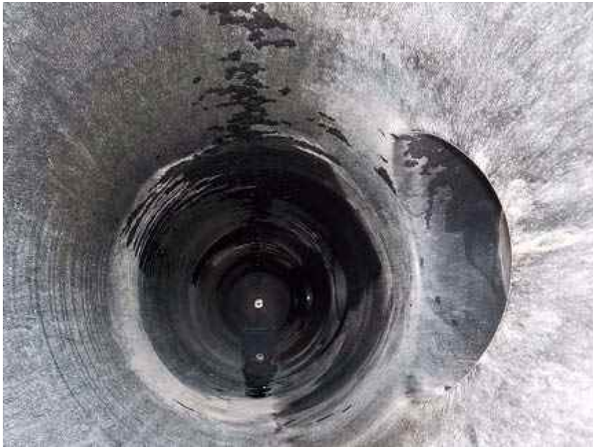
図 3-22 ユニット B 凝縮器 海水ヘッダ配管内
