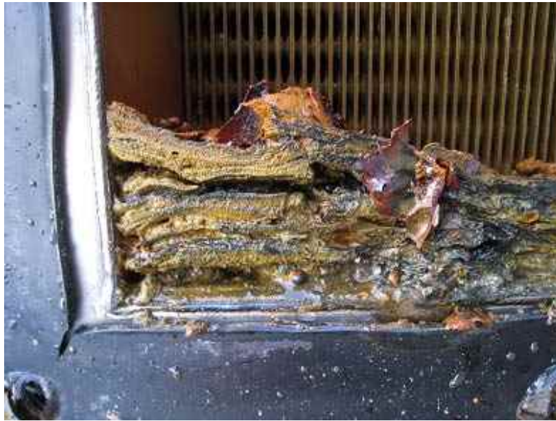
図 3-12 ユニット A 蒸発器プレートバンドル入口下部の土の堆積（洗浄前）
