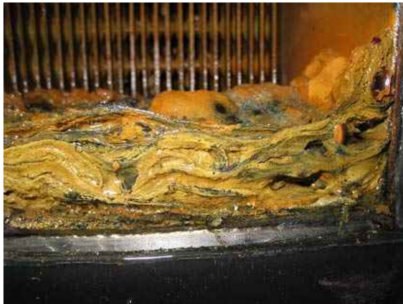
図 3-13 ユニット A 蒸発器プレートバンドル入口下部の土の堆積（洗浄前）
