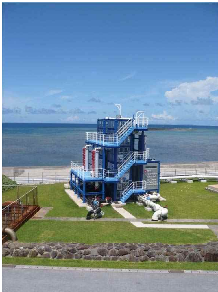
図 1-1 沖縄県海洋温度差発電実証試験設備
