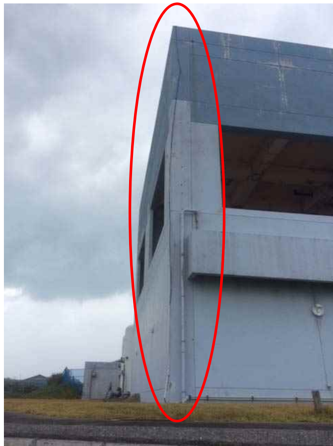
図 2-10 【写真】2014 年 10 月 台風による信号ケーブル破断
