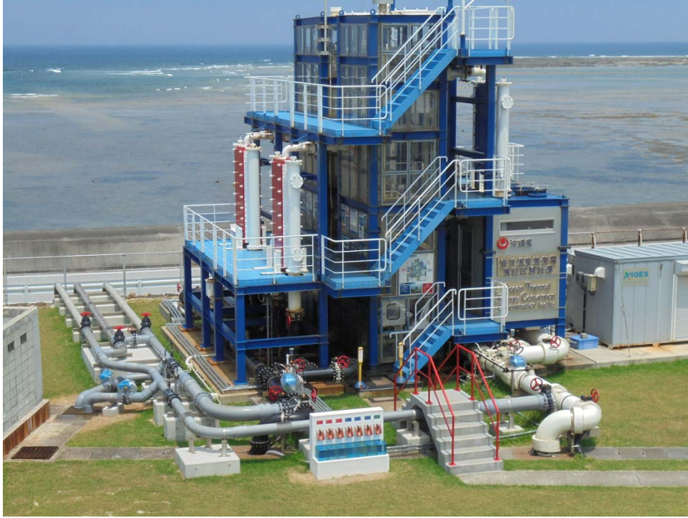
図 2-6 現況写真: 発電後海水配管および温度表示小型水槽
