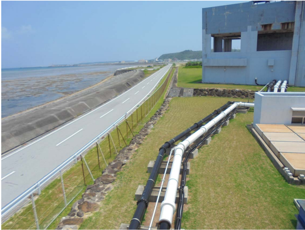
図 2-8 現況写真：発電後海水配管ま設部（フェンス左側の芝生部に埋設）
