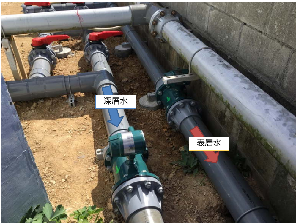
図 2-9 現況写真：発電後海水配管および流量計（海ぶどう養殖場内）
