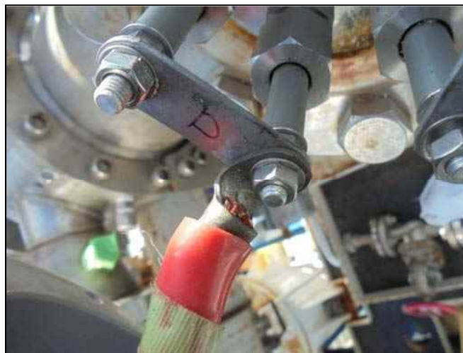
図 3-33 発電機電力ケーブル端子部(ボルト摩耗)
