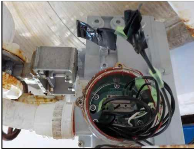
図 3-32 作動流体流量調整弁 LV211B 駆動部の状況
