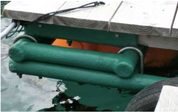
写真－8 鋼管の駆体をFRP処理した浮棧橋 (平成23年度に取り替え)
