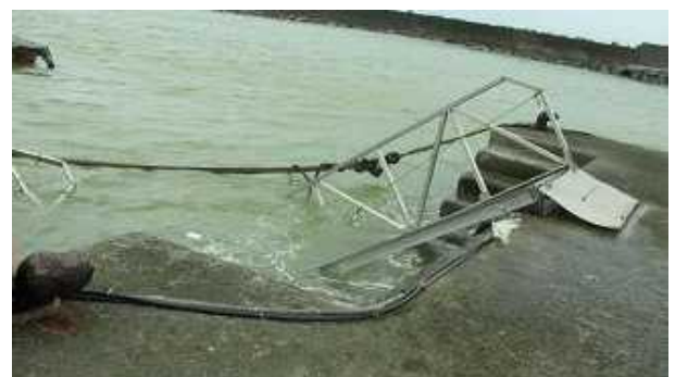
写真-4 海中に転落したアルミ製の渡り橋
