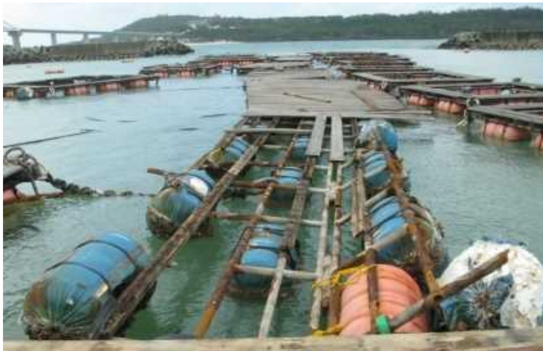
写真－5 老朽化の進んだ浮棧橋の残骸
