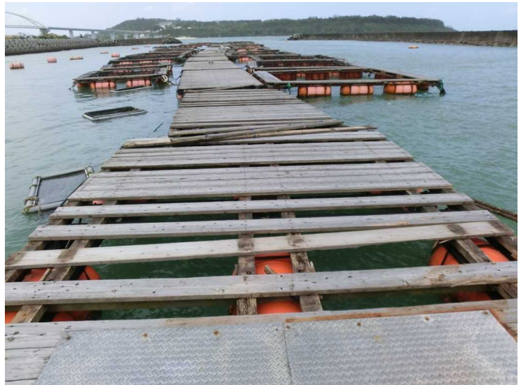
台風16号で被災した浮棧橋(H16年度取り替え分) 棧橋の上板が波浪・うねりの衝撃で剥離している。
