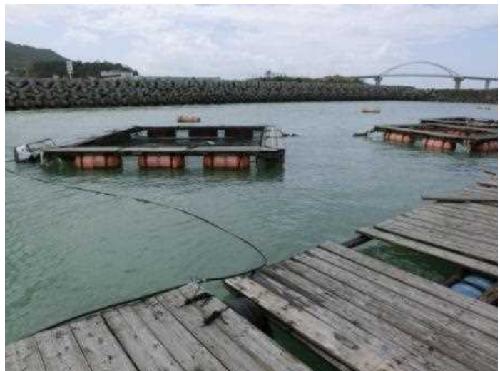
浮棧橋が大破して係留索が切れ、生簀が遊離状態
