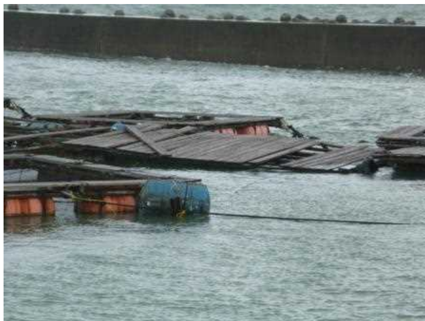
大破した浮棧橋(平成6年度整備分)
