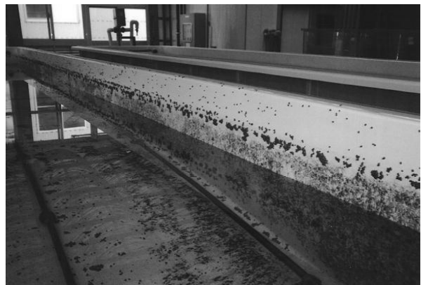
タフバンドを取り付けていない水槽(水を落としたところ)
