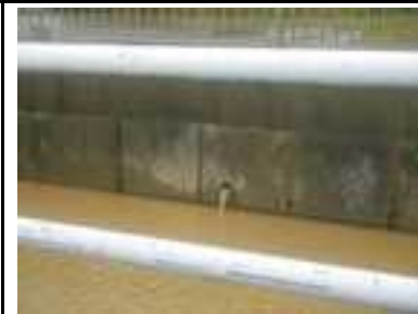
⑧ 北側支川上流域の状況(濁り有り)
