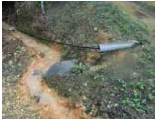
大小堀河口 大規模造成裸地からの濁水流出 (今年度)
