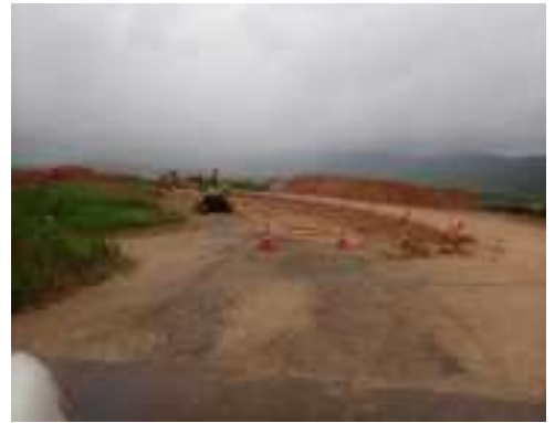
宮良川河口 圃場工事による濁水流出 (今年度)
