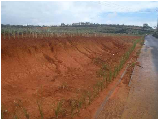
地点⑤ 道路への流出痕(但しグリーンベルト対策あり)
