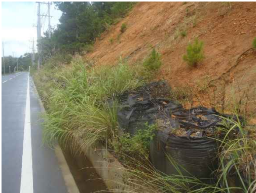
地点⑦ 土砂崩れ箇所対策(草本により改善)
